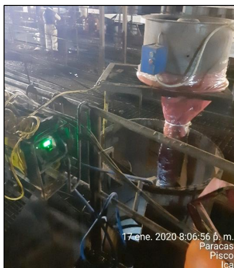
Figura 2: Sistema de Ventilación Utilizado
