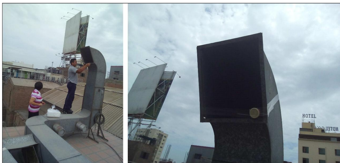
Figura 18. Instalación de dispositivo de carbón activado en la chimenea
