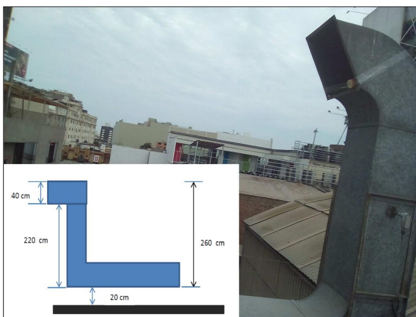
Figura 35. Chimenea de la instalación
